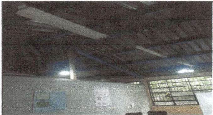
Foto 3: Reparación de sistema eléctrico: sustitución de lámparas de 2X40; sustitución de interruptores, reparación de cableado eléctrico y sustitución de ducto eléctrico + accesorios.
